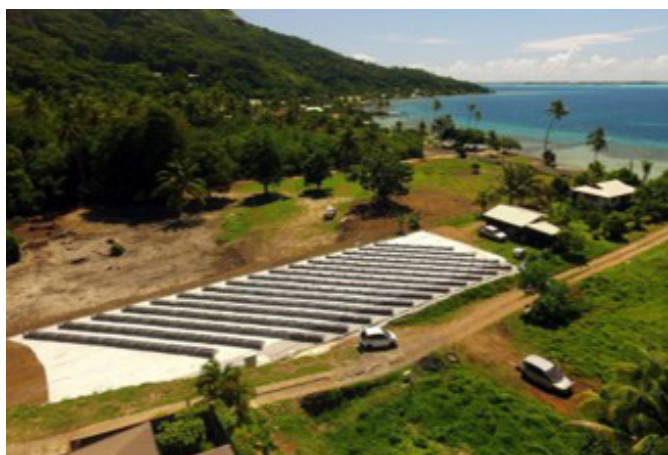
Vue du générateur solaire de 60kWc de l'installation de l'OSMOSUN@80 – Source : Mascara-NT
