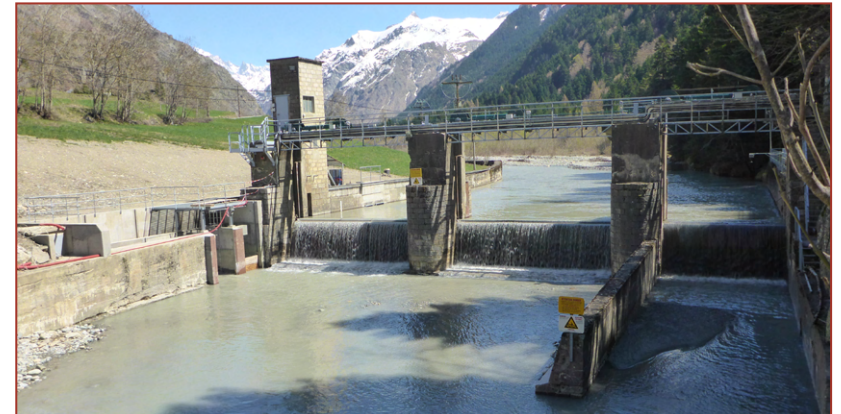
> Prise d'eau d'une usine hydroélectrique sur la Séveraisse (Source: MRE) |
