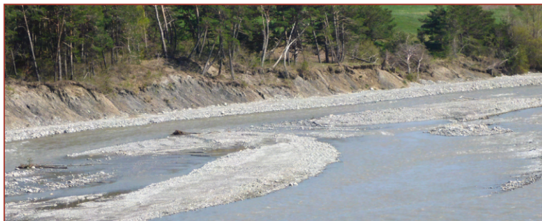
> Enfoncement du lit du Drac Blanc (Source : MRE)
