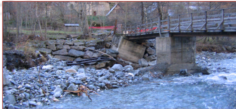
> Pile de pont endommagée lors d'une crue (Source: MRE) |
